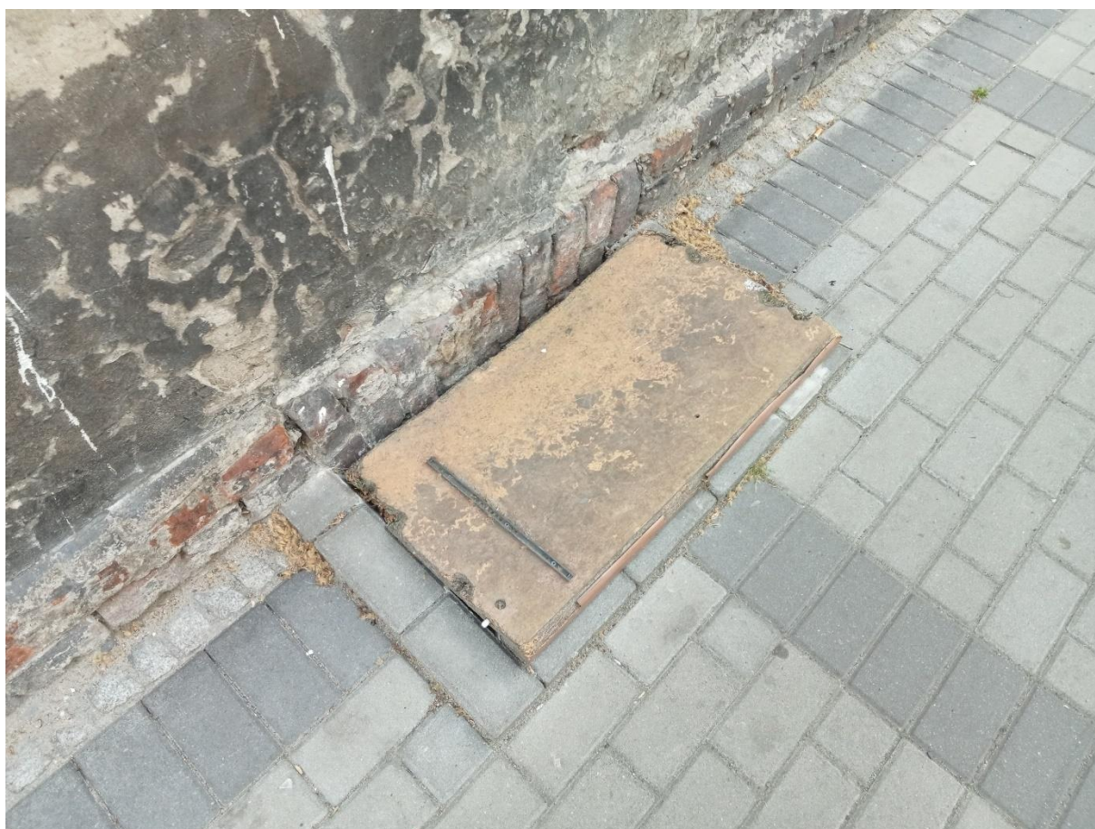
Rysunek 13. Prowizoryczne rozwiązanie techniczne stwarzające niebezpieczeństwo w ciągu ruchu pieszych (ul. Wandy)
