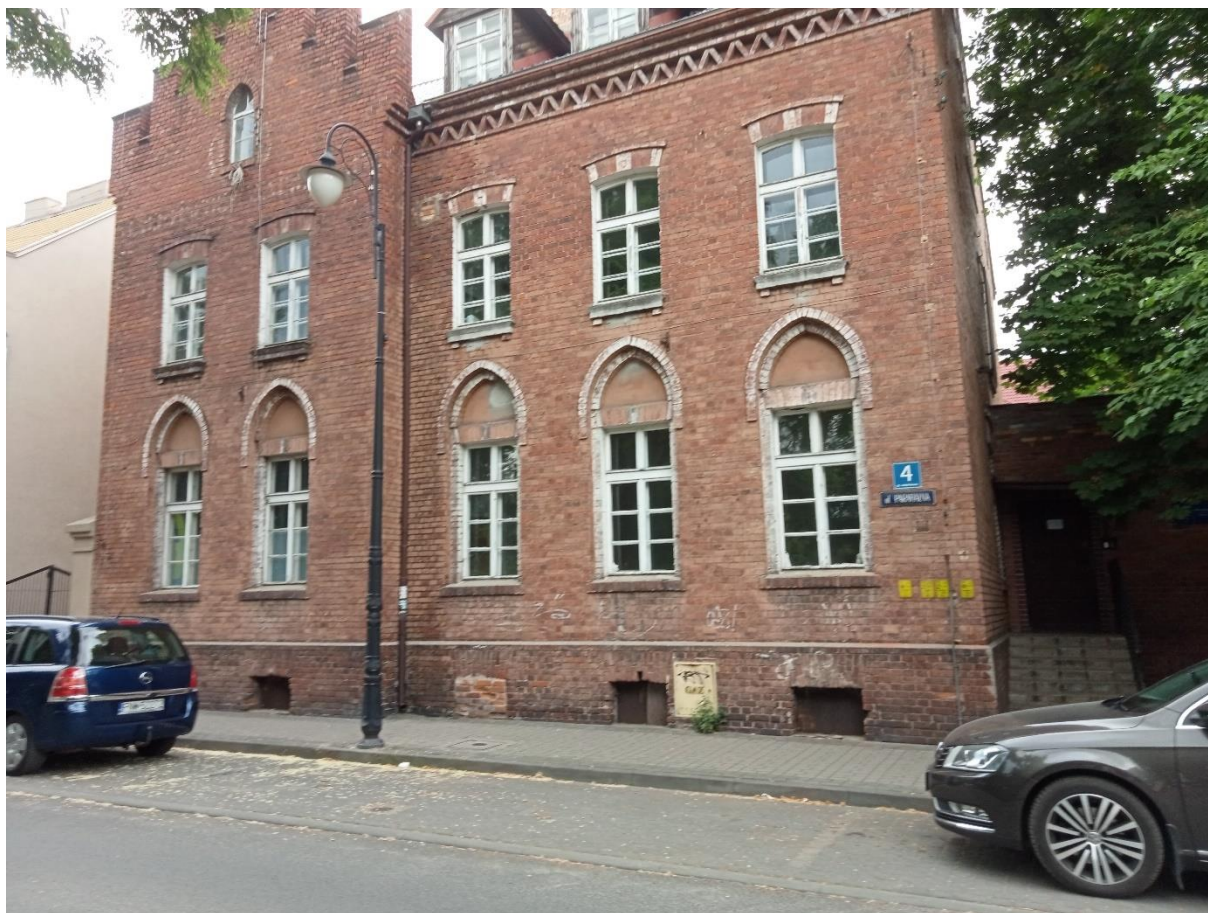
Rysunek 18. Stan techniczny budynku przy ul. Parafialnej 4
