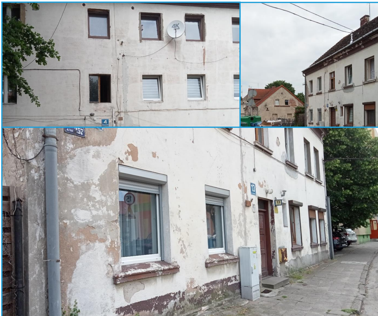
Rysunek 15. Stan techniczny wybranych budynków mieszkalnych znajdujących się w granicach obszaru rewitalizacji (ul. Młynarska)
