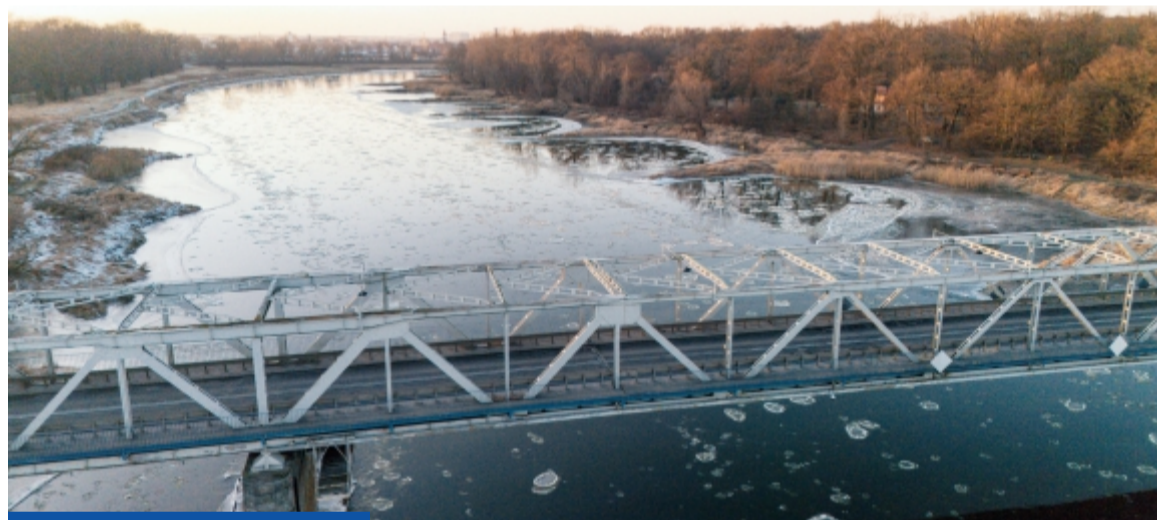
Ekspertyzy rzeczoznawców po powodzi z jesieni 2024 r. wskazały jasno - konstrukcja mostu kolejnej powodzi może już nie wytrzymać (fot. M. Bigos)
